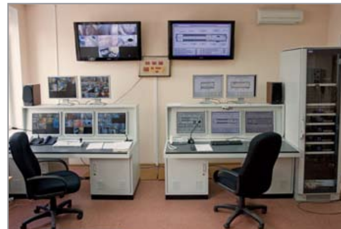
Центр управления комплексом
